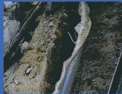
地面に露出しても破損がなかった ポリエチレン管(低圧導管)
